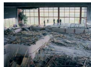
V roce 1985 povolil zavěšený betonový strop krytý plovárnou v Usteru, ve Švýcarsku. Stropní spojovací prvky z nerezavějící oceli nevykazovaly žádné vnější známky poškození, ale uvnitř byly v některých případech zcela zničené v důsledku popraskání způsobeného korozi napětím.
